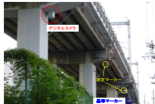
図 4-2 設置状況写真
