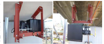
図 4-3 取付位置状況写真
